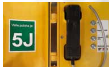
Na konci velkých tunelů a u únikových průchodů jsou telefonní stanice pro nouzové spojení s pracovníky Správy železnic, kteří řídí provoz v tunelu.
