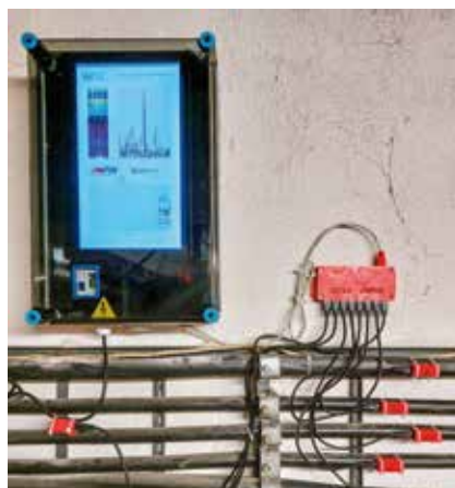
Umístění prototypu monitorovacího zařízení
