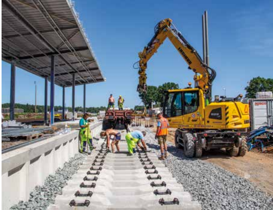
Pilně se pracuje také na rekonstrukci trati ze stanice Pardubice-Rosice nad Labem do Stěblové.
