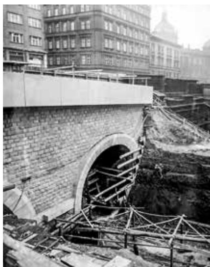
Tak vypadala stavba nejzápadnějšího tubusu, kterým jezdí vlaky směrem na Smíchov a Beroun
