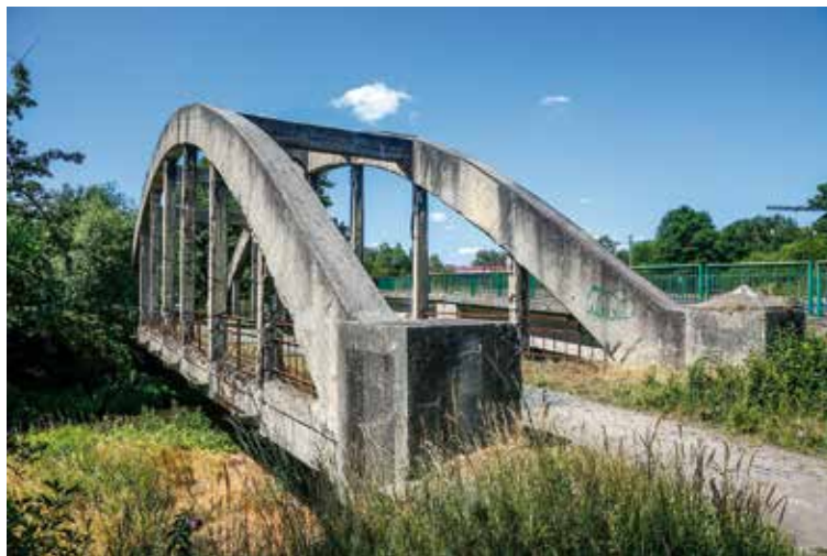
Historický most přes Svatavu zatím marně čeká na opravu.
