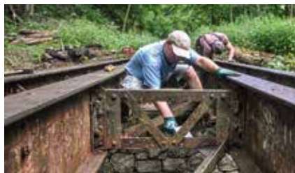
Oprava mostku přes Luční potok v 8,0 km, kde prozatím končí koleje od Zubrnice.
