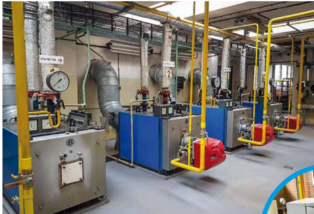
Kotle na budově DZS: Pankrác-Servác-Bonifác a záložní Zikmund. Nedávno proběhla modernizace hořáků, díky čemuž došlo k výraznému snížení emisí.
