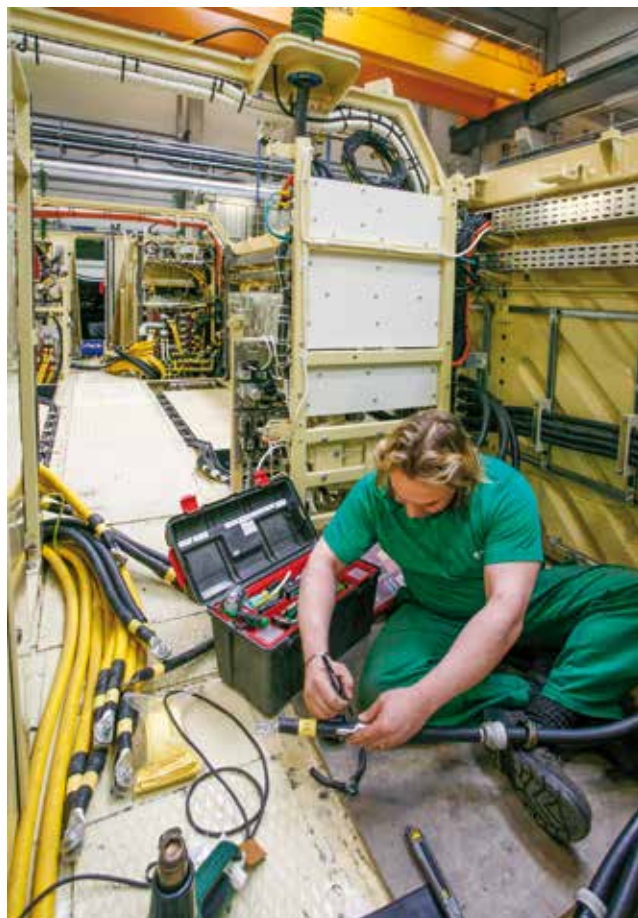
Na výrobě a vývoji ŽKV se podílí řada profesí, hlavně však elektrotechnici
