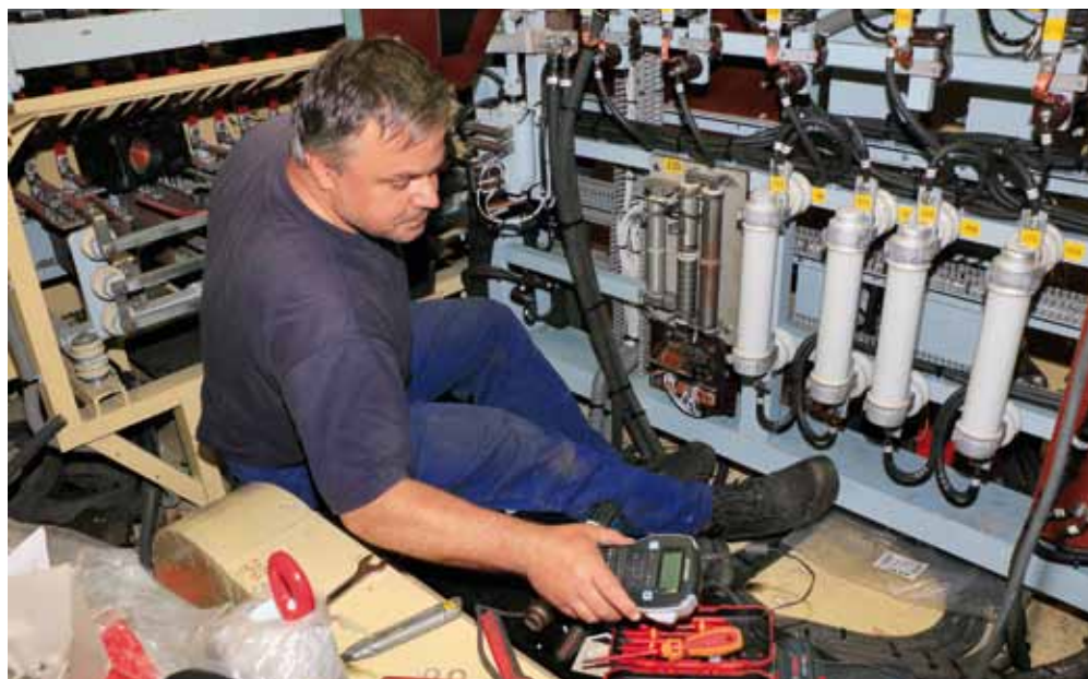
Elektromechanik společnosti DPOV v útróbách renovovaného šestikoláku 182.168
